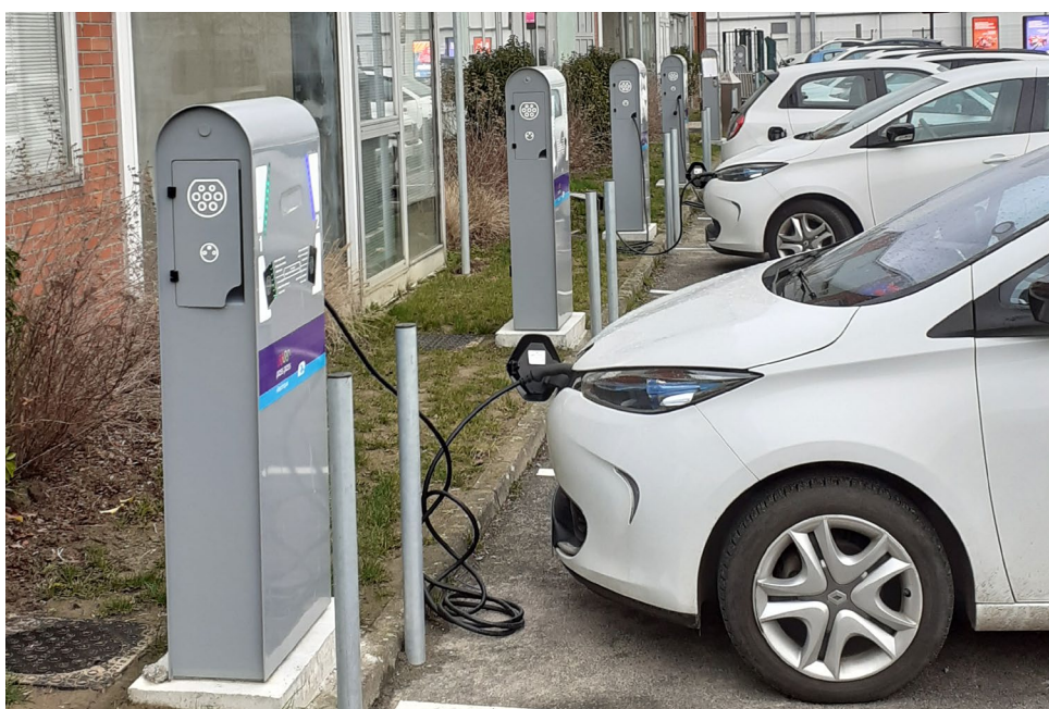
Bornes de recharge pour véhicules électriques
